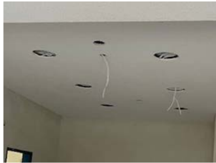
Elektroinstallationen für die Lichter an den Decken
